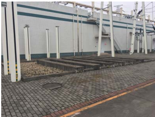
3 号主变基础、支架及油坑
